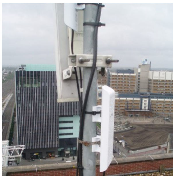
Installatie op flat “De Kijker”
