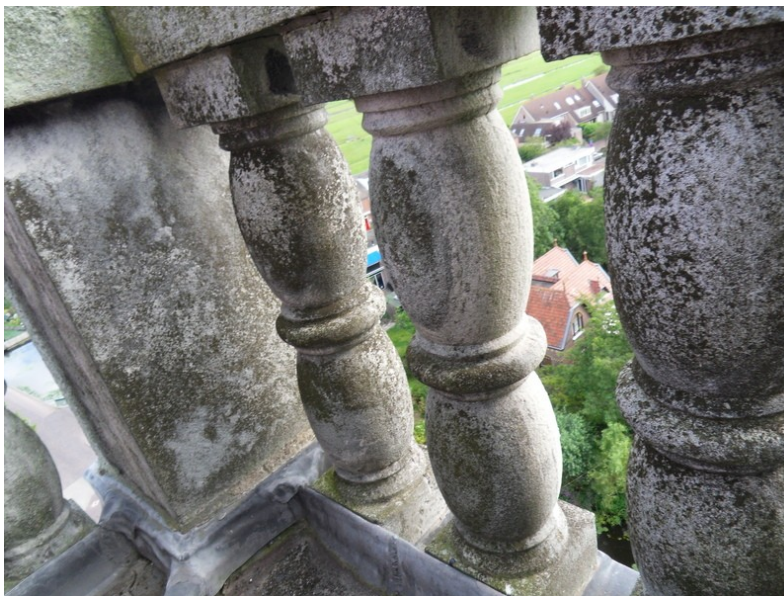
Voorbeeld van de pilaren. De antennes worden a) aan de zijkant van de pilaar en b) zo ver mogelijk naar binnen vast gemaakt. Hierdoor verstoren ze het monumentale karakter van de kerk niet.
